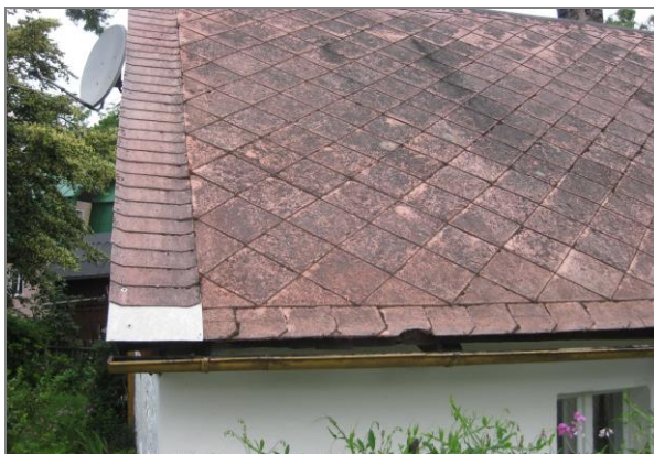
Fot. 2 Płyty azbestowo-cementowe płaskie
