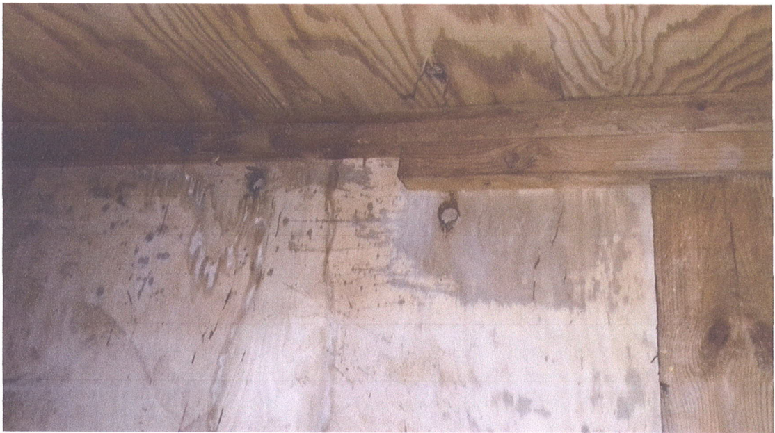
Zdjęcie nr 16, odkrywka nr 2, wewnątrz między dźwigarami, ciemne przebarwienia wilgotnościowe pasa górnego, sklejki pod pokryciem,
