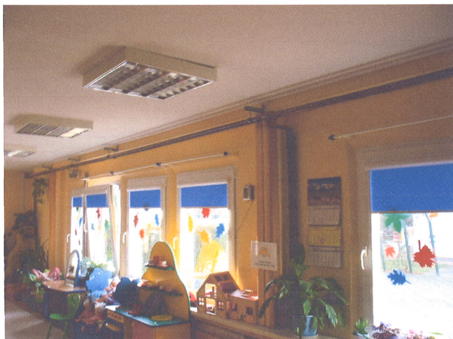
Zdjęcie nr 39, wewnątrz pomieszczeń, pęknięcie na ścianie przy oknie,
