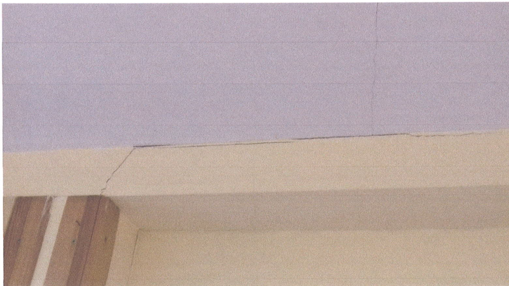
Zdjęcie nr 33 wewnątrz pomieszczeń zarysowanie na ścianie w suficie,
