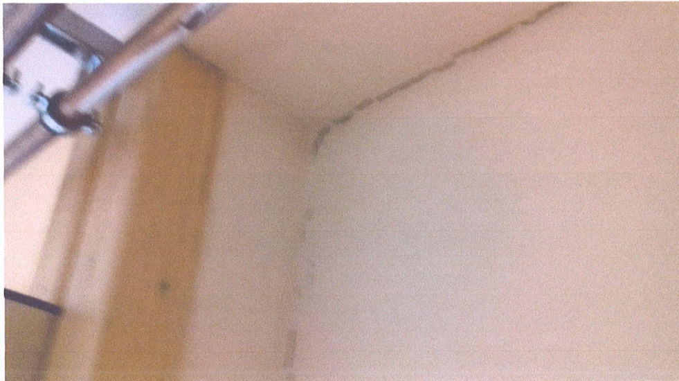
Zdjęcie nr 32 wewnątrz pomieszczeń zarysowanie na ścianie w narożu i w suficie,
