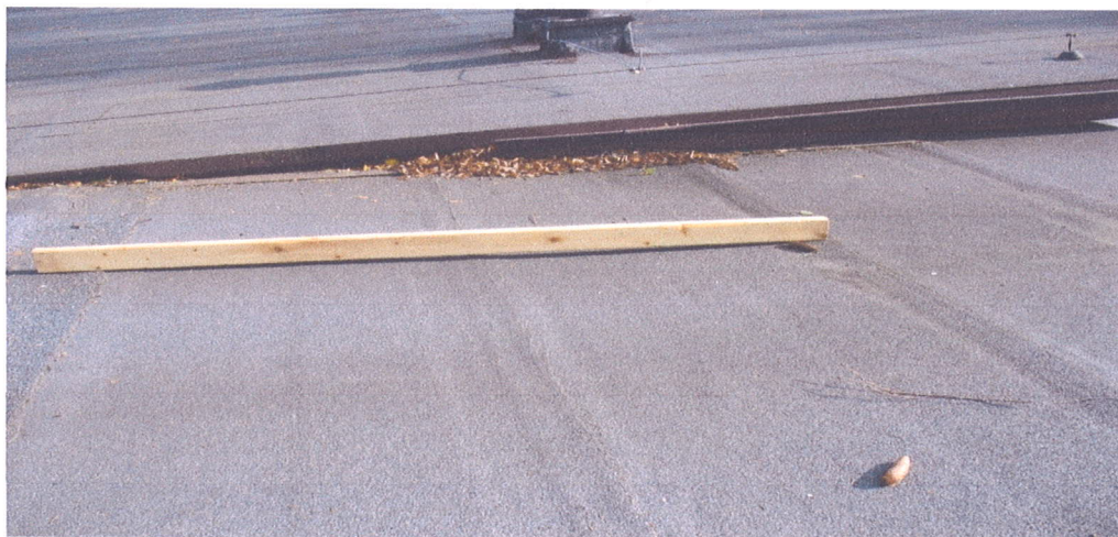
Zdjęcie nr 47, dach, pokrycie z widocznymi lokalnymi deformacjami,
