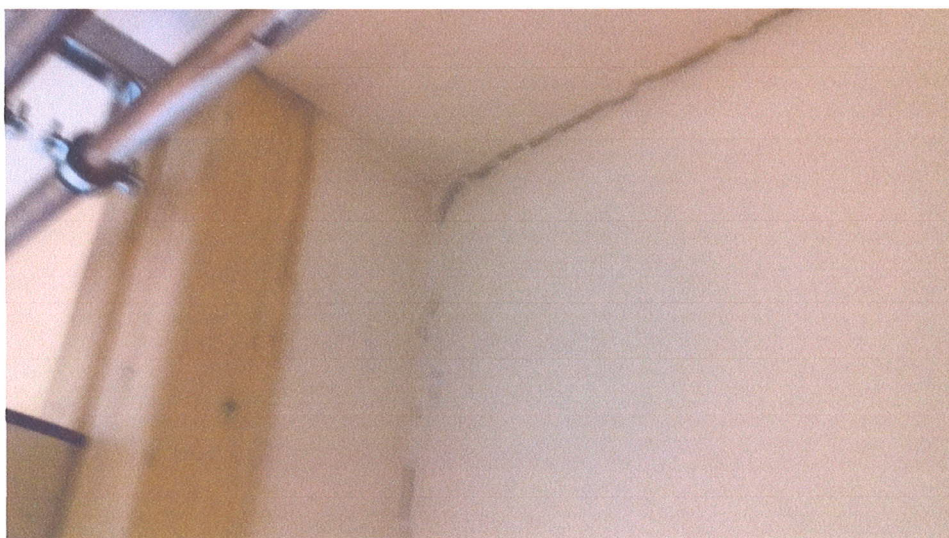
Zdjęcie nr 37, wewnątrz pomieszczeń zarysowanie na styku ściany i sufitu,
