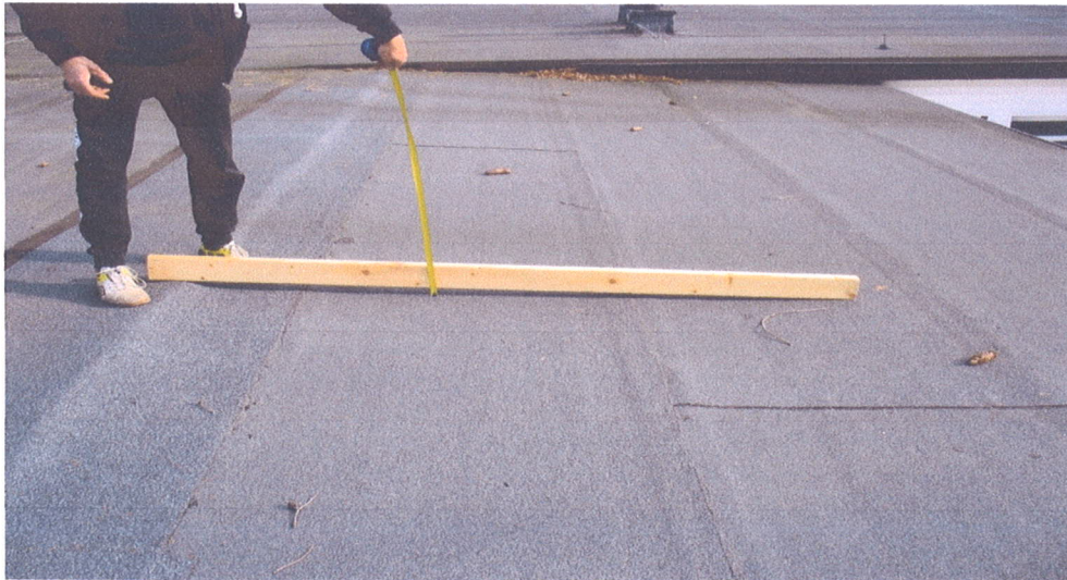
Zdjęcie nr 46, dach, pokrycie z widoczną lokalną deformacją, łąta oparta jest na garbie, jest to konstrukcja kratownicy,
