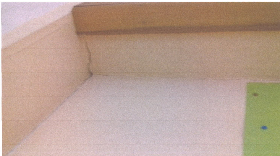
Zdjęcie nr 36, wewnątrz pomieszczeń zarysowanie na styku ściany i sufitu,
