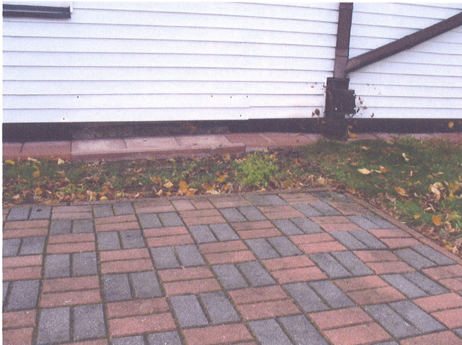
Zdjęcie nr 6 położenie opaski z płytek chodnikowych, elewacji, zniszczenie podwaliny fundamentowej pod panelami elewacji,
