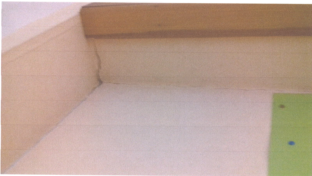
Zdjęcie nr 29 wewnątrz pomieszczeń zarysowanie na ścianie w narożu,
