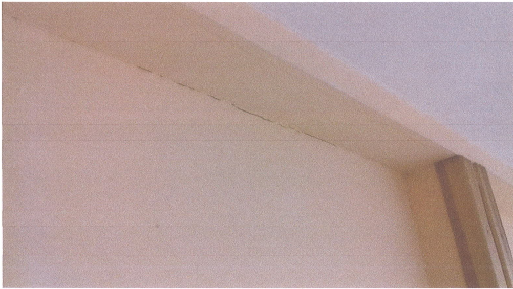
Zdjęcie nr 30 wewnątrz pomieszczeń zarysowanie na ścianie,
