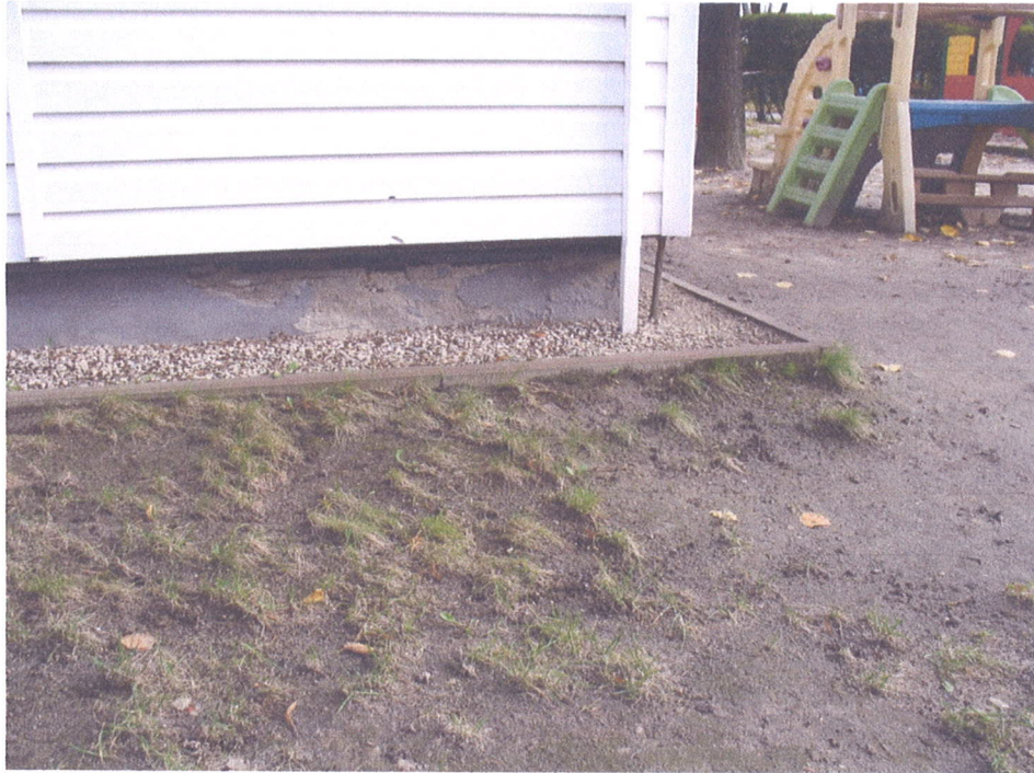
Zdjęcie nr 5 położenie opaski i elewacji, zniszczenie podwaliny fundamentowej,
