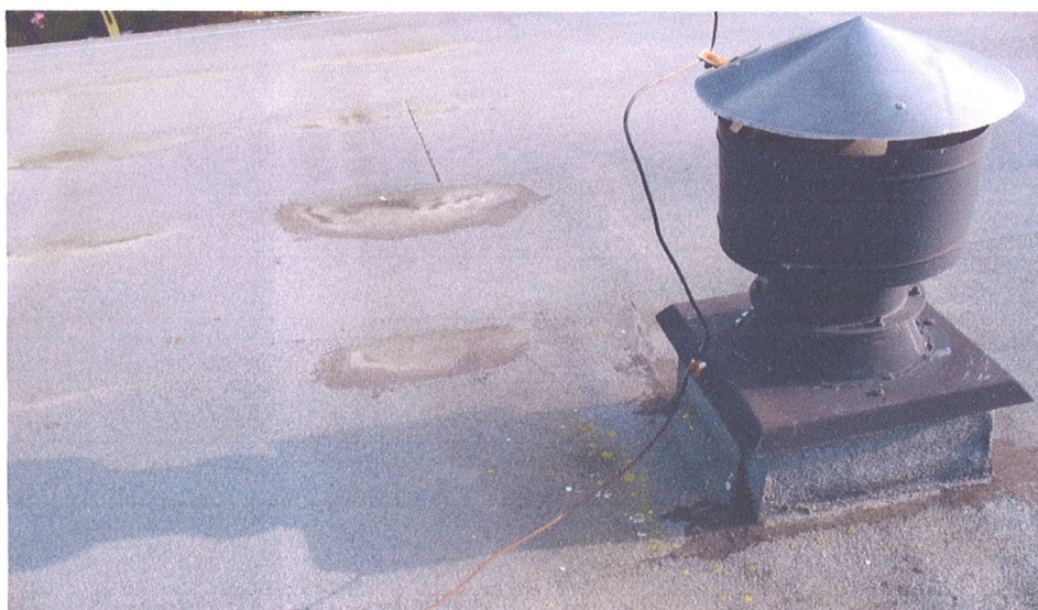
Zdjęcie nr 45, dach, pokrycie z widocznymi lokalnymi deformacjami
