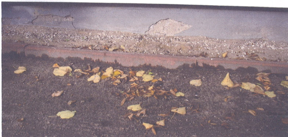
Zdjęcie nr 3, zniszczona powłoka podwaliny, fragment opaski, zakres prac wskazano do naprawy,
