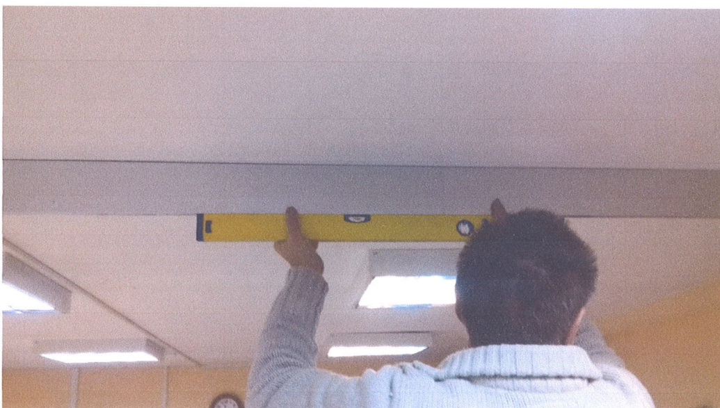
Zdjęcie nr 23, wewnątrz pomieszczeń zarysowanie na suficie podwieszonym, pomiar ugięcia i deformacji sufitu, widoczny brak prześwitów i poziom bez odchyłań,
