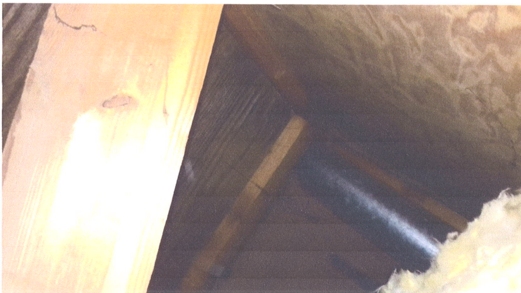
Zdjęcie nr 14, odkrywka nr 2, wewnątrz po drugiej stronie dźwigara, widoczny fragment stężenia, podbicia, ciemne przebarwienia wilgotnościowe podbicia, zniszczenia struktury sklejki pokrycie i środka dźwigara,
