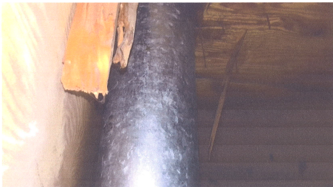
Zdjęcie nr 13, odkrywka nr 2, wewnątrz po drugiej stronie dźwigara, widoczny fragment podbicia, ciemne przebarwienia wilgotnościowe podbicia, zniszczenia struktury sklejk,
