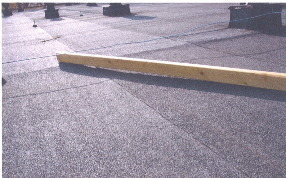
Zdjęcie nr 44, dach, pokrycie z widocznym lokalną deformacją, łąta oparta jest na garbie, jest to konstrukcja kratownicy,
