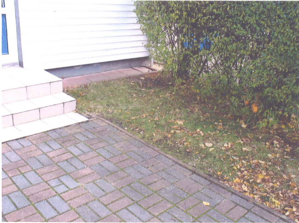
Zdjęcie nr 7 położenie opaski z płytek chodnikowych, elewacji nad płytkami chodnikowymi, które zapadły się poniżej krawężnika opaski,
