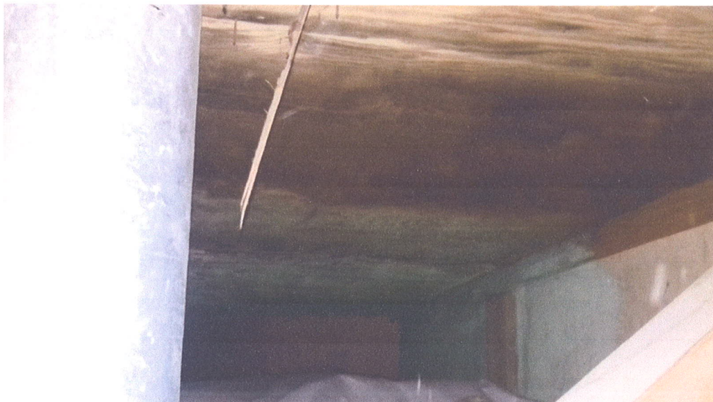
Zdjęcie nr 18, odkrywka nr 2, wewnątrz między dźwigarami, ciemne przebarwienia wilgotnościowe pasa górnego, sklejki pod papami,
