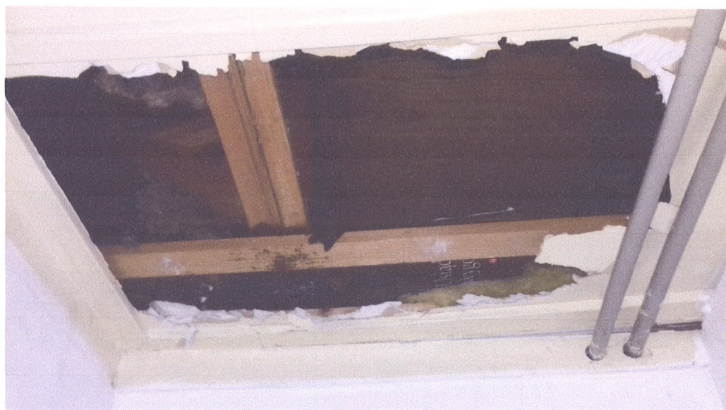
Zdjęcie nr 9, odkrywka nr 2, fragment zdjętego sufitu z płyt GK, widoczny ruszt sufitu, dolny pas kratownicy, izolacja, wełna mineralna, wnętrze i konstrukcja deskowania pod papy,
