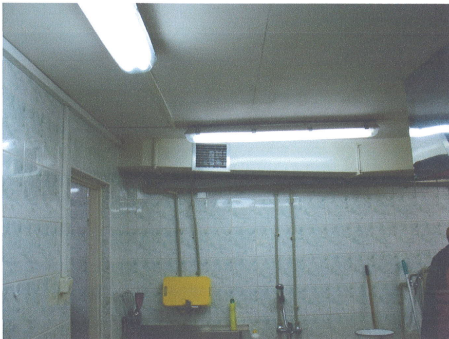
Zdjęcie nr 42, wewnątrz pomieszczenia, pęknięcie sufitu GK,
