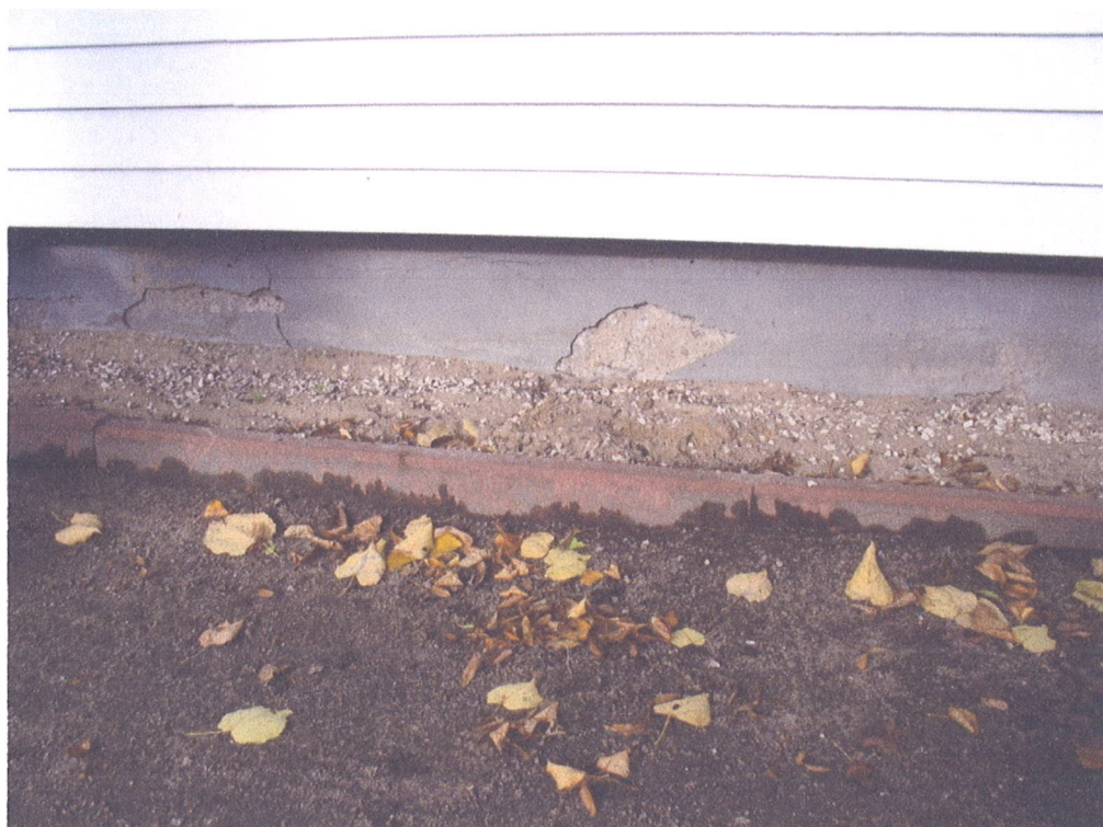
Zdjęcie nr 8 położenie opaski, brak kruszywa, zniszczenie powłoki podwaliny,
