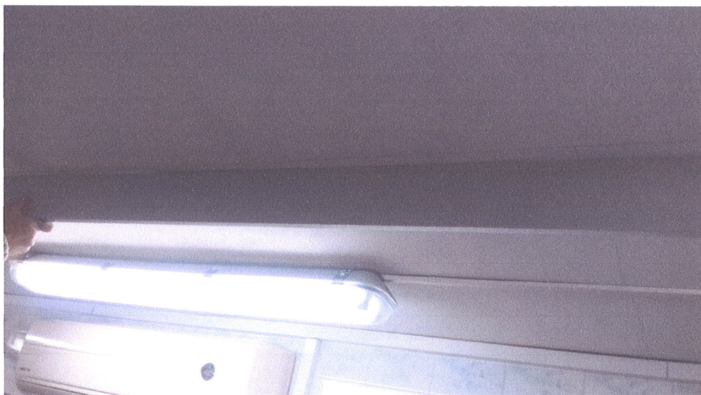
Zdjęcie nr 24, wewnątrz pomieszczeń zarysowanie na suficie podwieszonym, pomiar ugięcia i deformacji sufitu,
