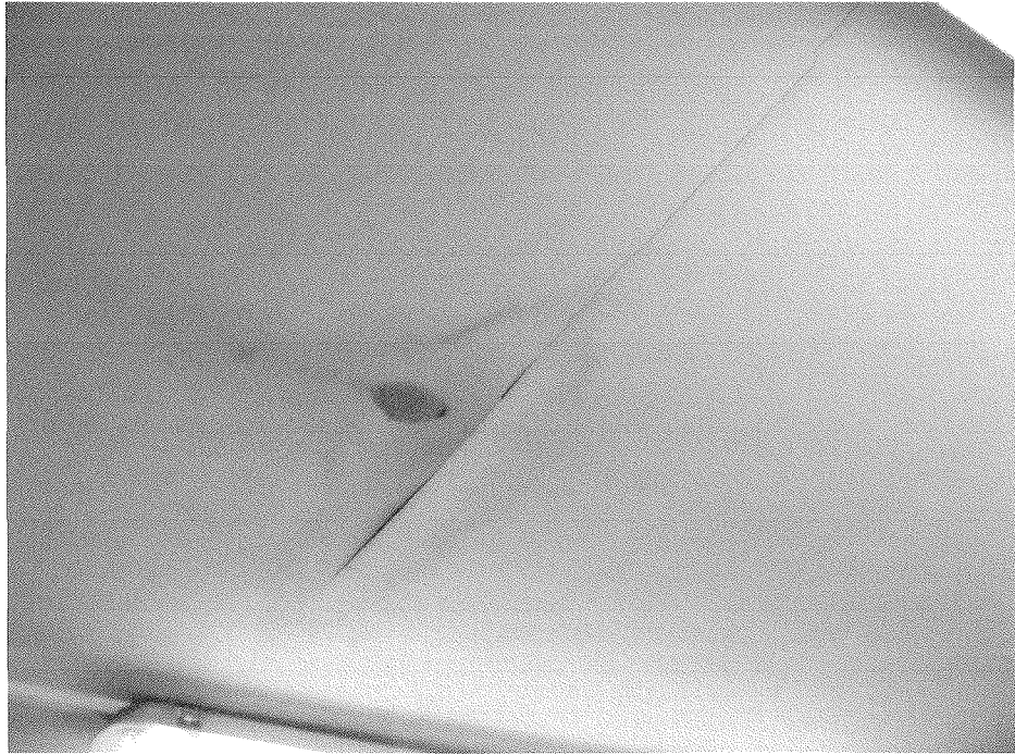
Zdjęcie nr 40, wewnątrz pomieszczenia, pęknięcie rysa ukośna,
