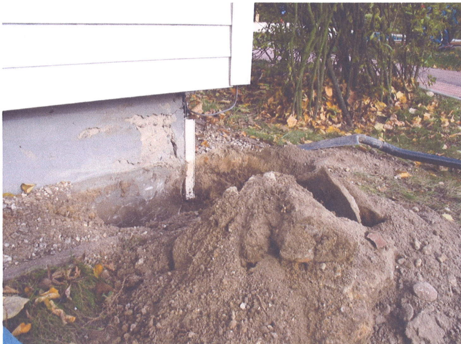
Zdjęcie nr 2, odkrywka nr 1 widok, opaska posiada posypkę z kruszywa, zniszczenia podwaliny fundamentowej,
