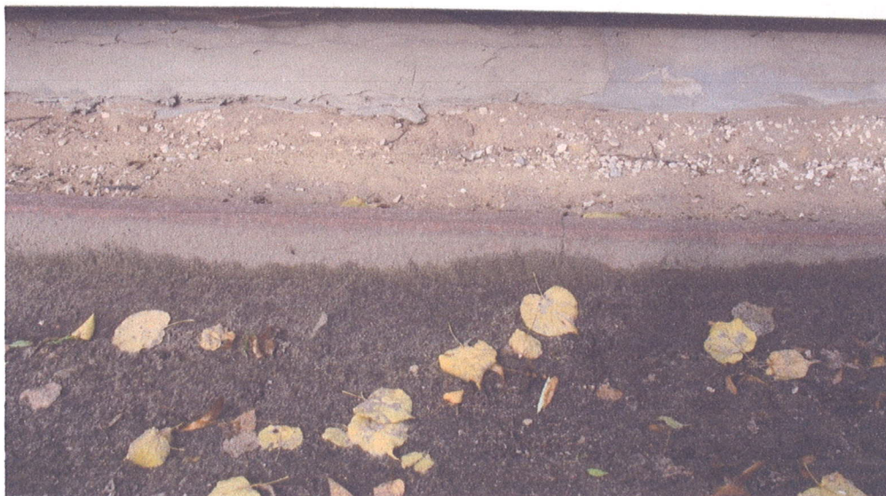
Zdjęcie nr 7 położenie opaski, brak kruszywa, zniszczenie powłoki podwaliny,
