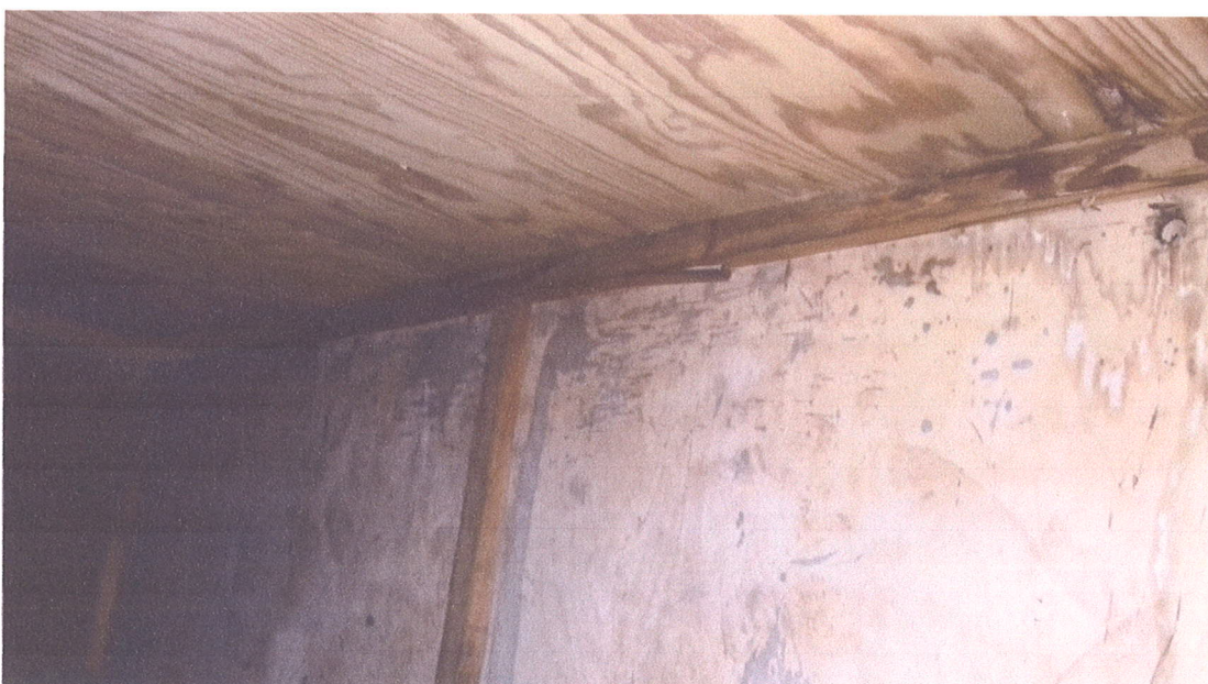
Zdjęcie nr 15, odkrywka nr 2, wewnątrz między dźwigarami, ciemne przebarwienia wilgotnościowe podbicia pasa górnego, sklejki pod pokryciem,
