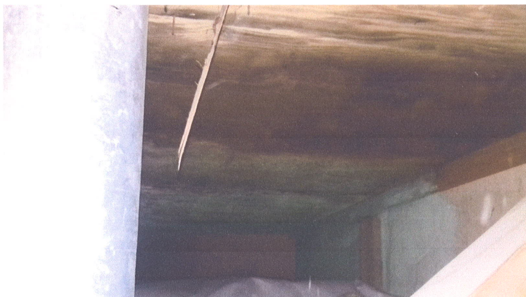
Zdjęcie nr 12, odkrywka nr 2, wewnątrz po drugiej stronie dźwigara, widoczny fragment powłoki ochronnej, ciemne przebarwienia wilgotnościowe podbicia, pasów górnych dźwigara,
