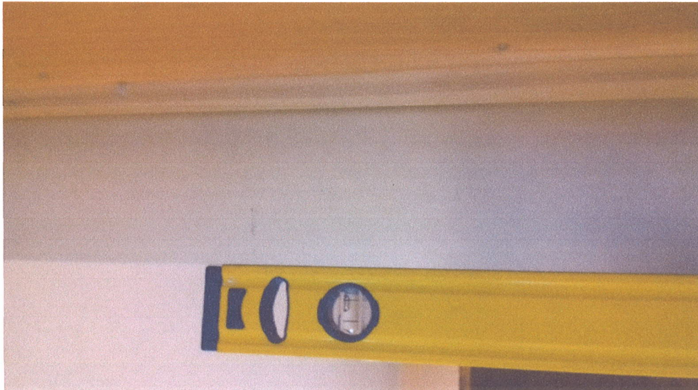
Zdjęcie nr 31 wewnątrz pomieszczeń odchylenie od pionu,
