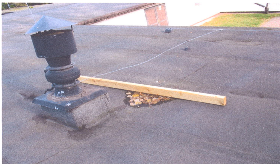
Zdjęcie nr 43, dach, pokrycie z widocznym lokalnym zniszczeniem, miejscowe zapadlisko pod Zdjęcie nr 15, dach, pokrycie z widocznym lokalnym zniszczeniem, miejscowe zapadlisko pod łąką, pozostałe w głębi, za kominkiem wentylacyjnym,
