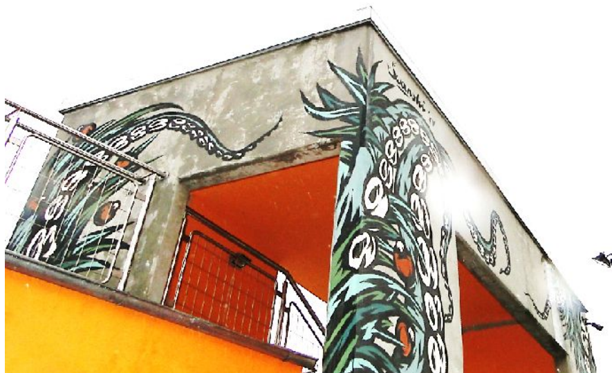
Fot. 38 Wadliwie wykonana wiatrownica zadaszenia nad schodami ( pionowa obróbka blacharska odprowadzająca wodę z tarasu, powodują powstawanie zacieków na elewacjach na
