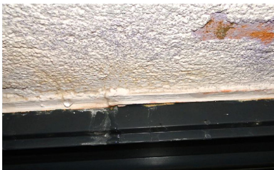
Fot. 28-32 Przecieki wody z nieszczelnie wykonanego odwodnienia liniowego, widoczne w nadprożu nad drzwiami wejściowymi pod schodami
