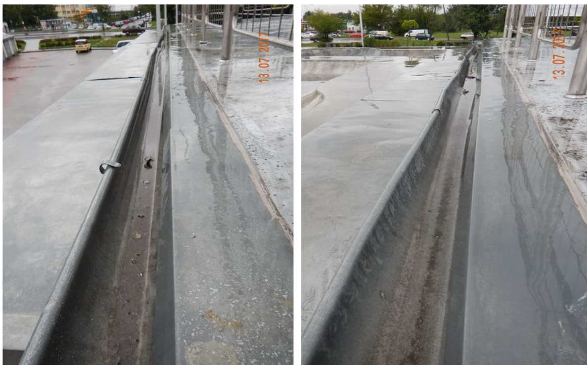
Fot. 43-44 Rynny nie mają odpowiednio ukształtowanego spadku zalega w nich woda
