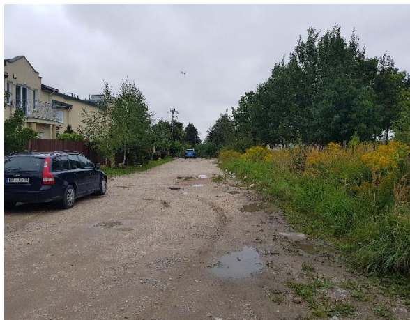
FOT. 2 UL. PRYMULKI - WIDOK W KIERUNGU UL. OSIEDLOWEJ (BRAK PRZEJAZDU)
