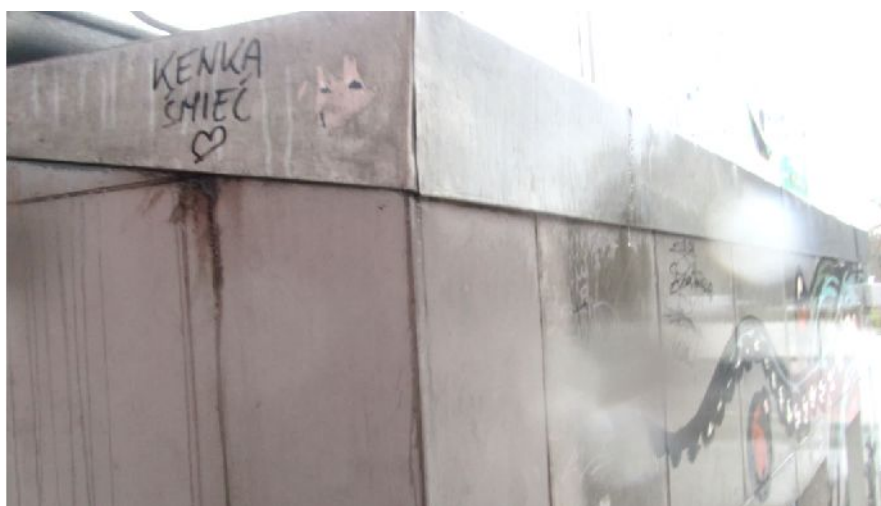
Fot. 35-36 W tym przypadku okapnik tarasu nie jest praktycznie w ogóle wysunięty poza lico ściany, a powinien być wysunięty 3-5cm
