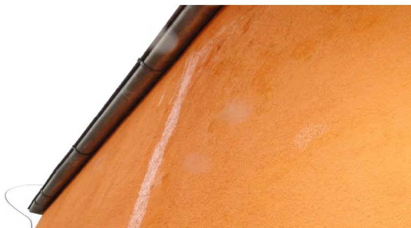
Fot. 41-42 Zaciek wodny na elewacji budynku widoczny podczas opadu deszczu. Zaciek spowodowany jest wadliwym wykonawstwem obróbek blacharskich na tarasie
