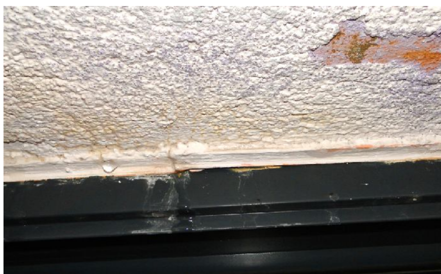
Fot. 28-32 Przecieki wody z nieszczelnie wykonanego odwodnienia liniowego, widoczne w nadprożu nad drzwiami wejściowymi pod schodami
