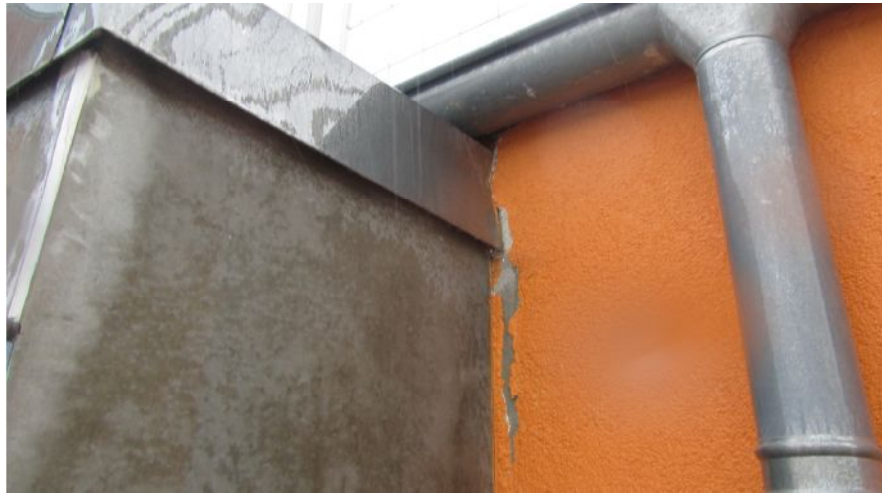
Fot. 37 Wadliwie wykonana wiatrownica tarasu ( pionowa obróbka blacharska odprowadzająca wodę z tarasu, powodują powstawanie zacieków na elewacji
