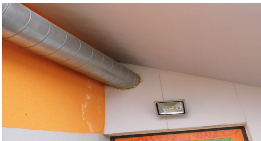
Fot. 26-27 Zaciek wodny widoczny jest również na fragmencie elewacji budynku przylegającym bezpośrednio do otworu drzwiowego
