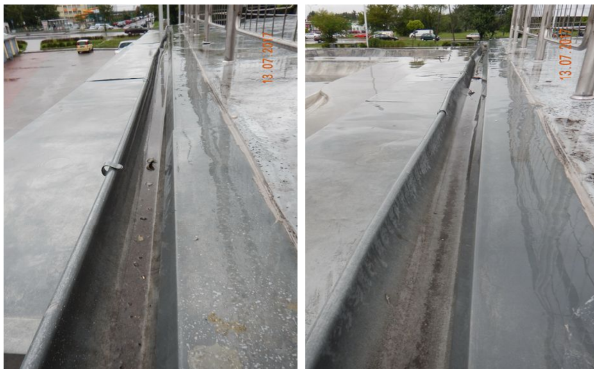
Fot. 43-44 Rynny nie mają odpowiednio ukształtowanego spadku zalega w nich woda
