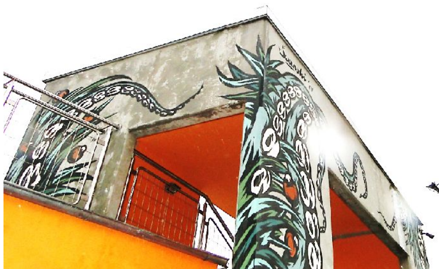
Fot. 38 Wadliwie wykonana wiatrownica zadaszenia nad schodami ( pionowa obróbka blacharska odprowadzająca wodę z tarasu, powodują powstawanie zacieków na elewacjach na
