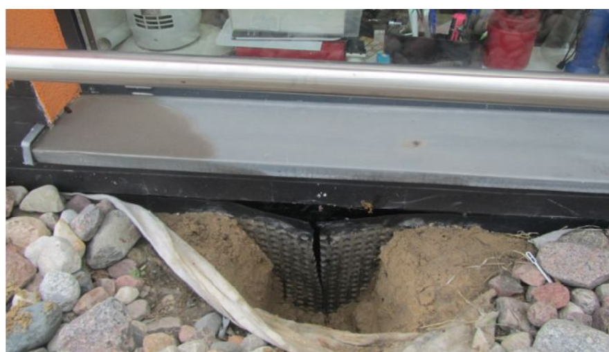
Fot. 9-10 Odkrywka od zewnątrz budynku tuż przy ścianie zewnętrznej. W odkrywce stwierdzono wykonanie zabezpieczenia ściany zgodnie z projektem i sztuką budowlaną
