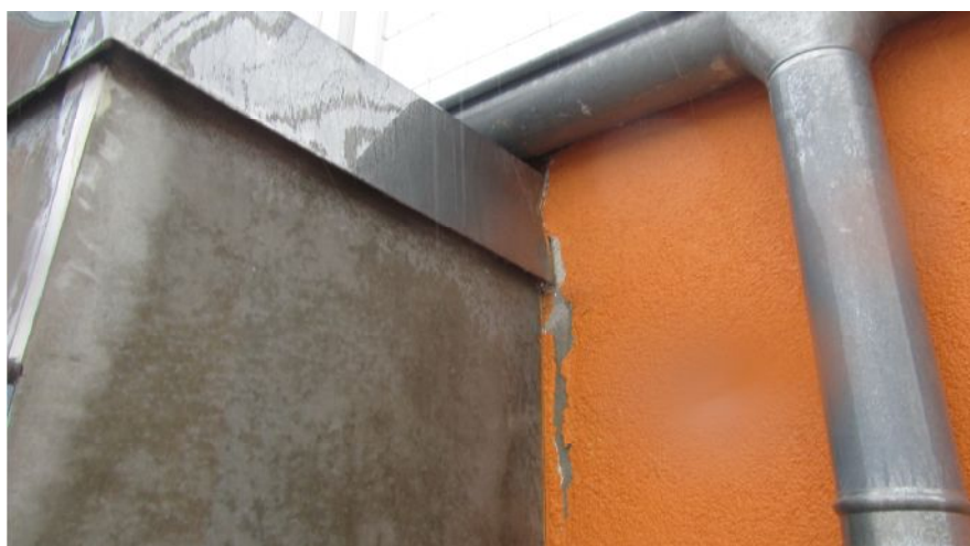
Fot. 37 Wadliwie wykonana wiatrownica tarasu ( pionowa obróbka blacharska odprowadzająca wodę z tarasu, powodują powstawanie zacieków na elewacji
