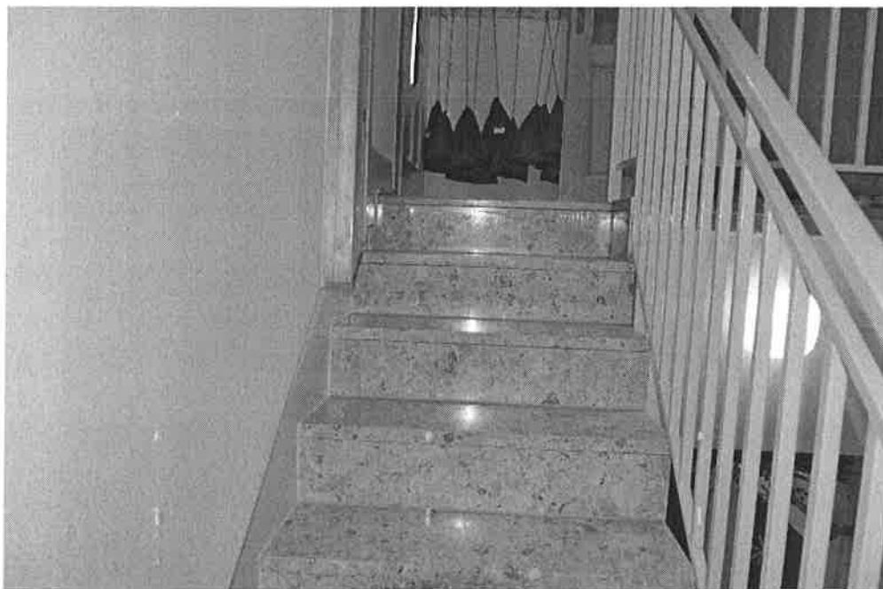
Fot. 5. Widok klatki schodowej na poddaszu, wysokość balustrady niezgodna z warunkami technicznymi, biegi schodów wykończone konglomeratem marmurowym.
