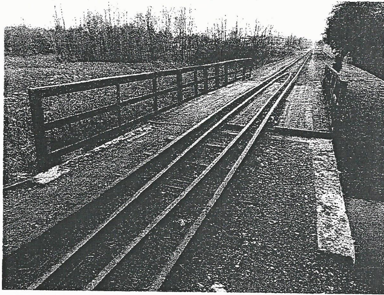
Fot. 12 – pomost chodników i wypełnienie między szynami drewniane, poręczce zagrażające bezpieczeństwu p.poż.
