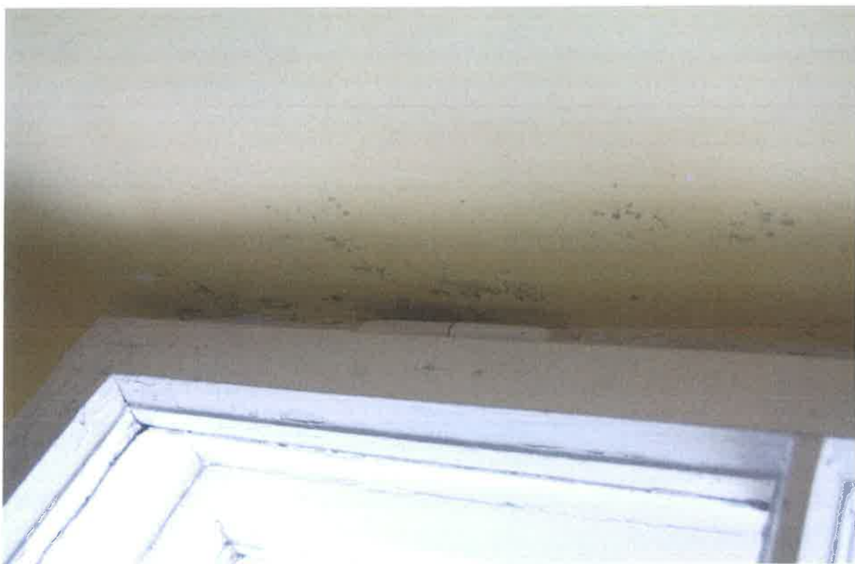
fot. 25. Zagrzybienie na około okna.
