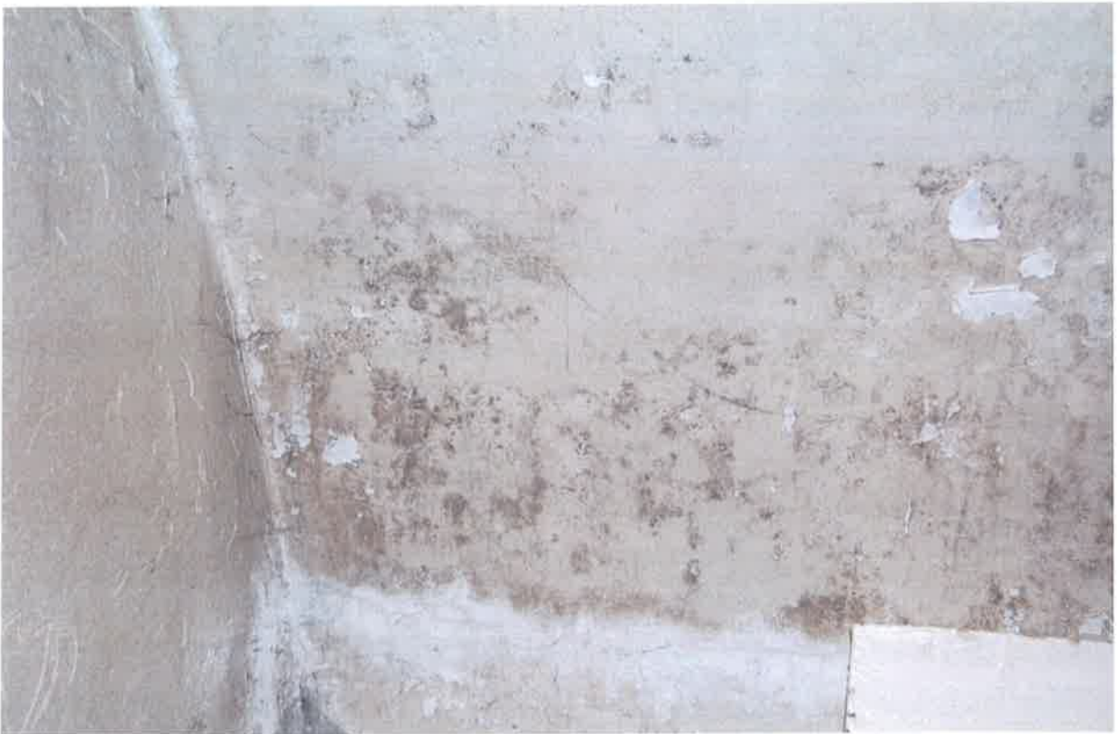
fot. 10. Zagrzybienie ścian.
