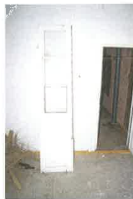
Uszkodzone zewnętrzne skrzydło drzwi na taras wschodni
