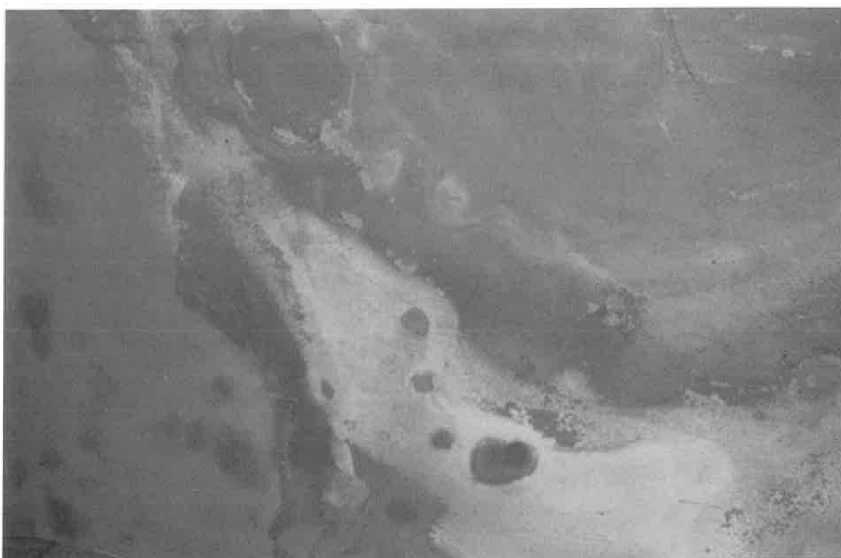
fot. 4. Wysolenia na ścianie w piwnicy.
