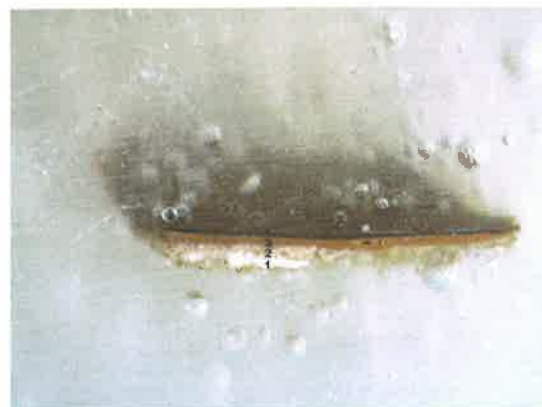
14. Przekrój poprzeczny próbki z drzwi ganku wsch. W najniższej warstwie biel
