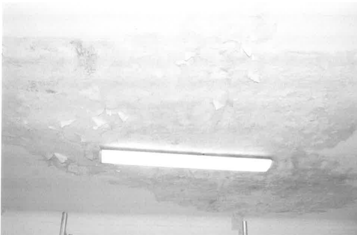
fot. 14. Zaciek na stropie.
