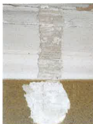
Odkrywka na gzymsie
