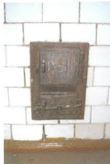
Drzwiczki pieca z pomieszczenia D
