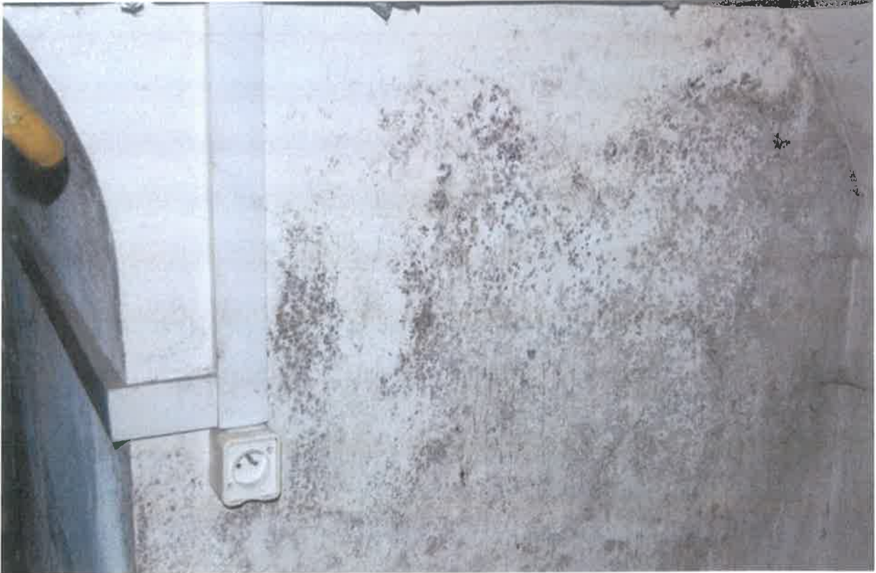
fot. 9. Pleśń na tynkach piwnica.
