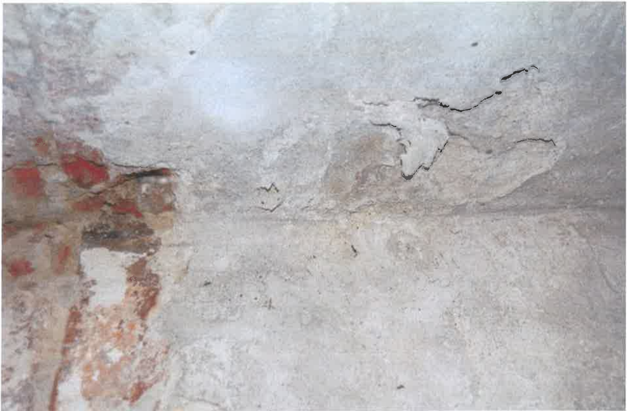
fot. 8. odparzone tynki.
