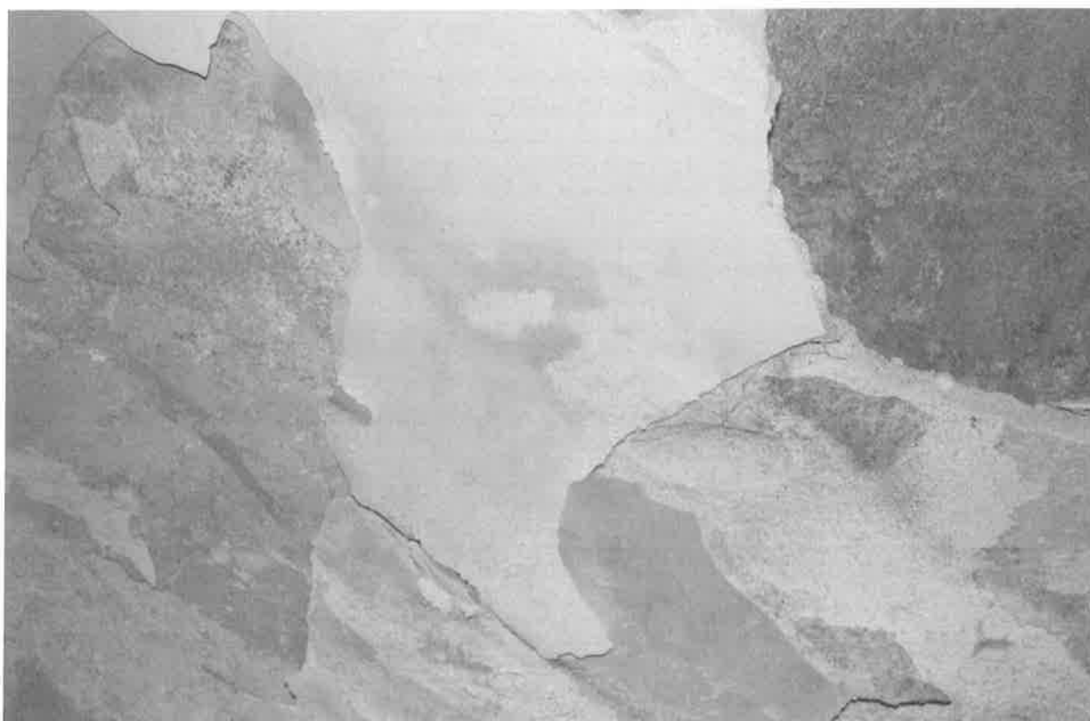
fot. 15. Odspojenia tynku pomieszczenie C.
