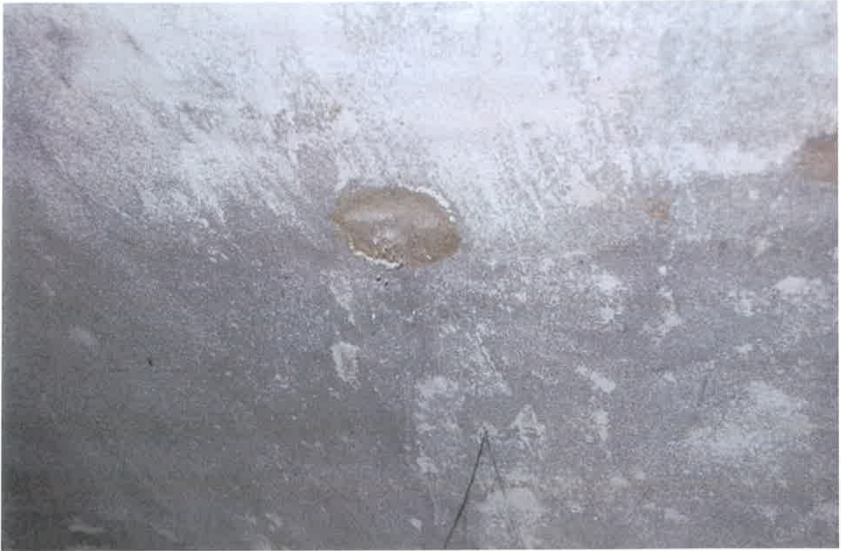
fot. 5. Wysolenia na nicianie w piwnicy.
