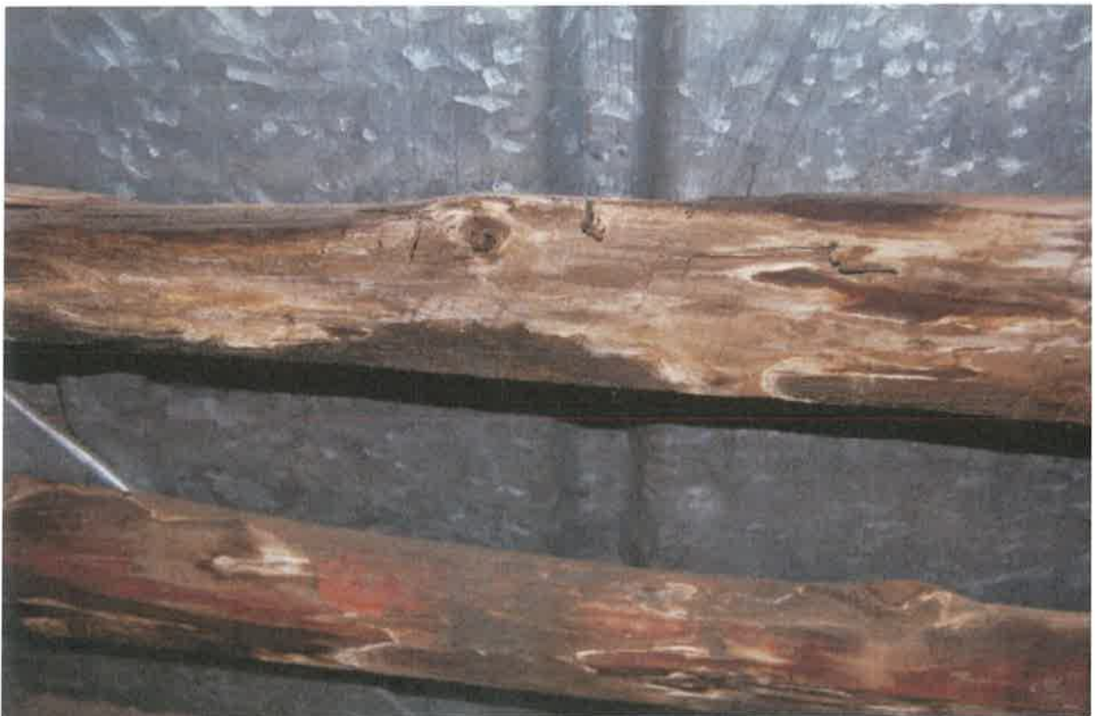
fot. 23. Zawilgocenie na łątach.
