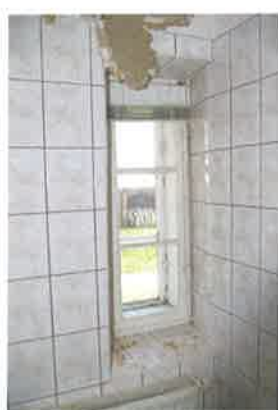
Okno wydzielone wtórną ścianą działową
