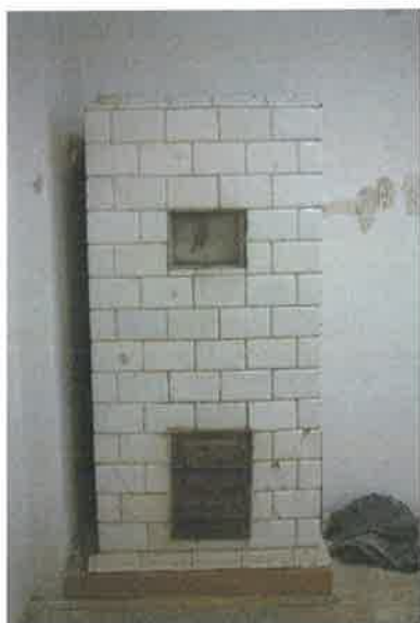
Piec 1 z pomieszczenia A
