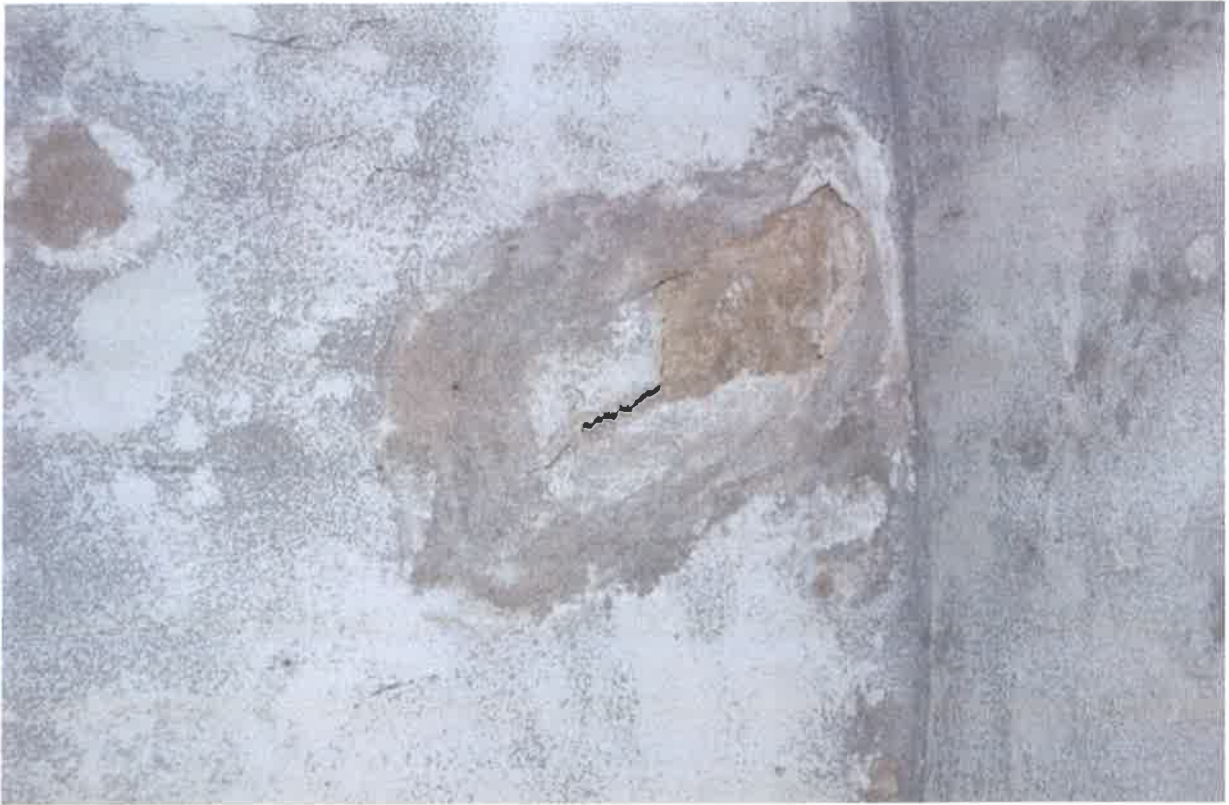
fot. 7. Odspojenia tynku.
