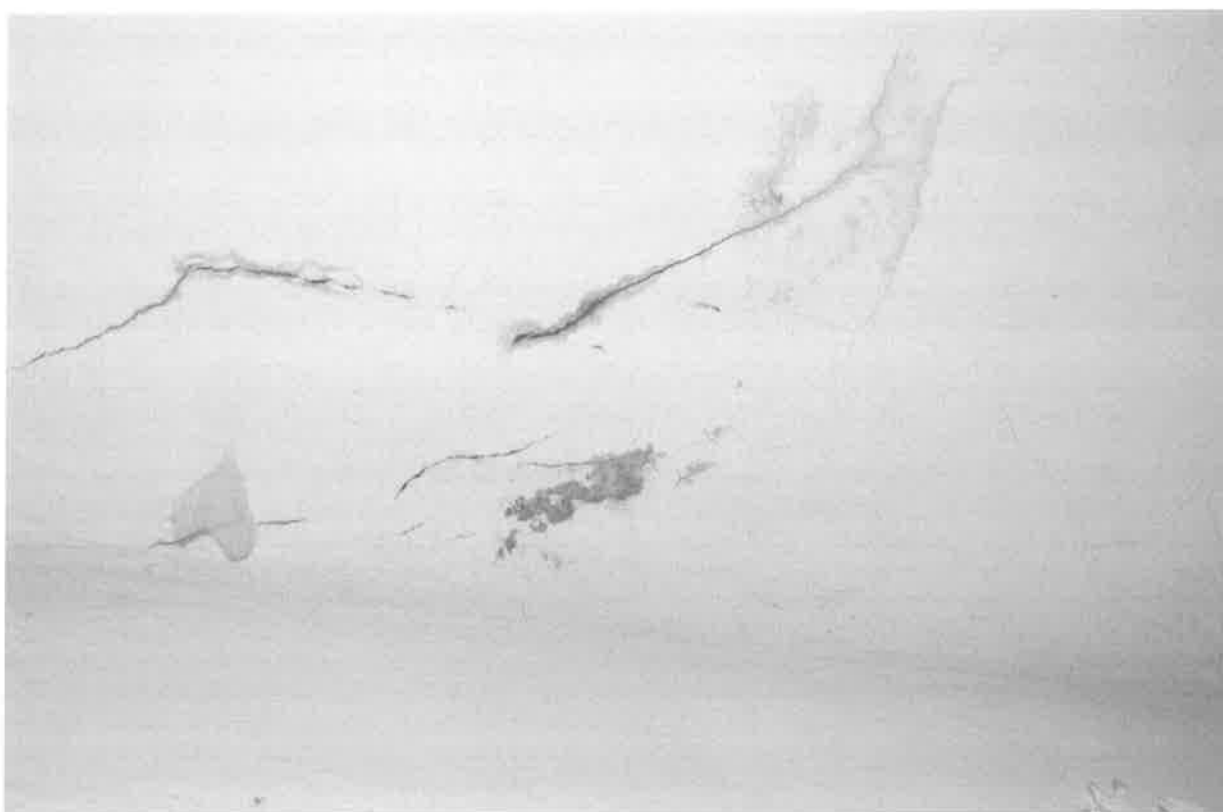
fot. 13. Pęknięcia i zacieki.
