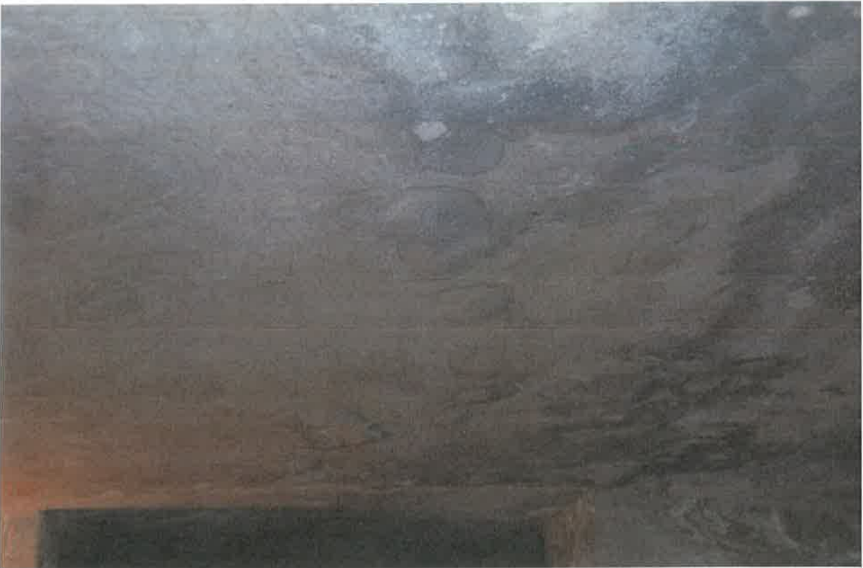
fot. 6. Zacieki i sól na sklepieniu piwnicy.
