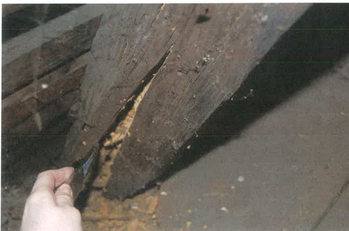
fot. 21. Stan krokwi.
