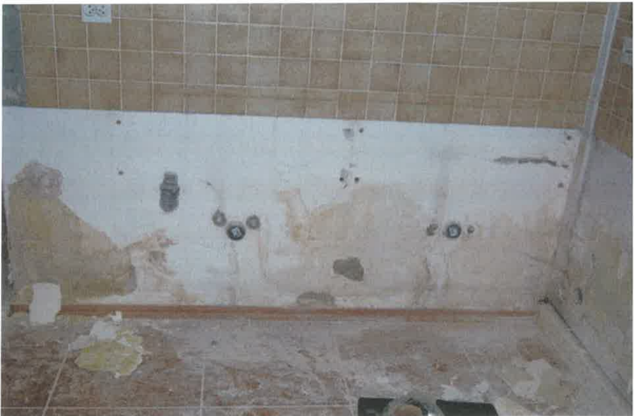
fot. 17. Stan tynków w łazienkach na parterze.
