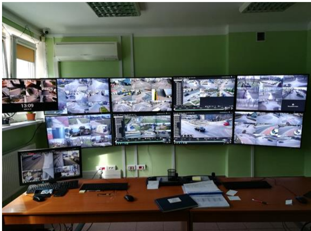
Sala operatorów monitoringu miejskiego na ul. Czajewicza 1 a w Piasecznie.
