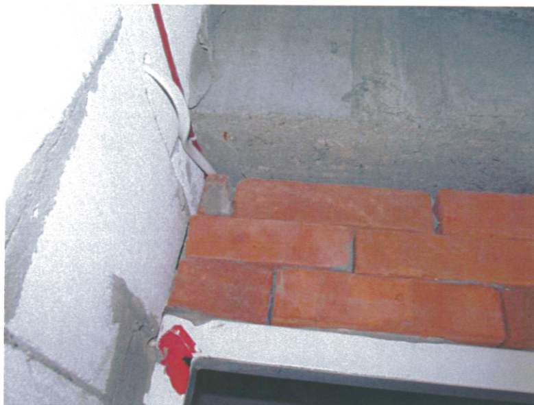
Zdjęcie [O-08] Stan techniczny budynku sądu rejonowego w Piasecznie przy ul. Kościuszki 14, w dniu 2 czerwca 2017 r. Brak nadproża nad otworem.
