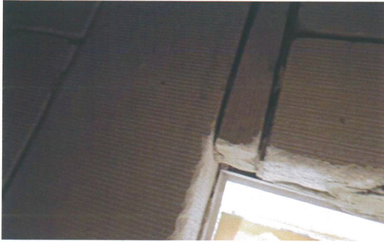
Zdjęcie [O-10] Stan techniczny budynku sądu rejonowego w Piasecznie przy ul. Kościuszki 14, w dniu 2 czerwca 2017 r. – zastosowanie zbyt małych bloczków do przemurowania ścian.
