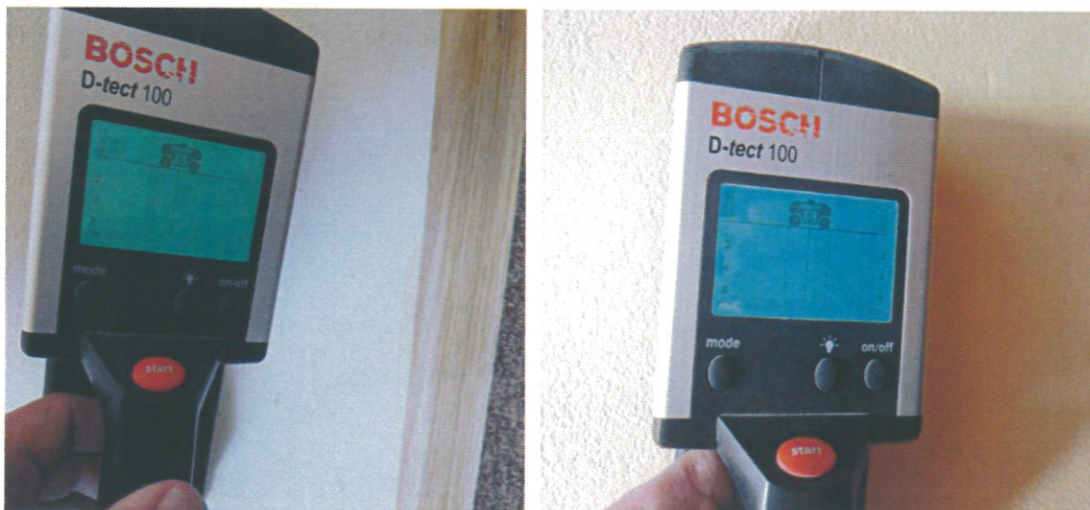
Zdjęcie [O-11] Stan techniczny budynku sądu rejonowego w Piasecznie przy ul. Kościuszki 14, w dniu 2 czerwca 2017 r.
