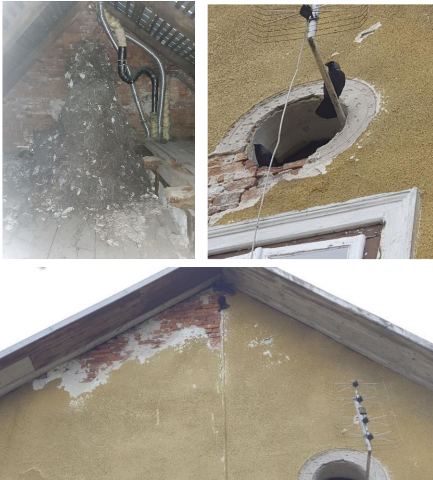
Ilustracja 1. Znacznych rozmiarów gniazdo kawek przy północnej elewacji obciążające strop, ptaki dostają się w przestrzeń poddasza przez okulus i otwór u szczytu elewacji, źródło: własne
