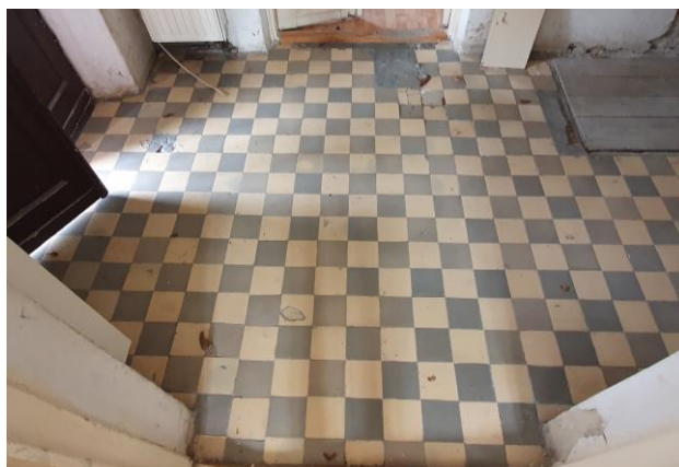
Ilustracja 3 Istniejąca w holu posadzka ceramiczna do renowacji
