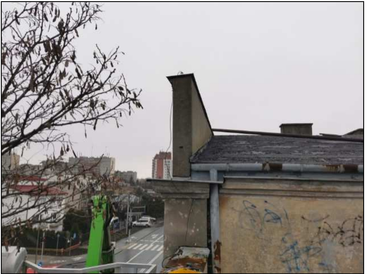
Fot.3, Ściana północna, wolnostojąca odchylona od pionu attyka
