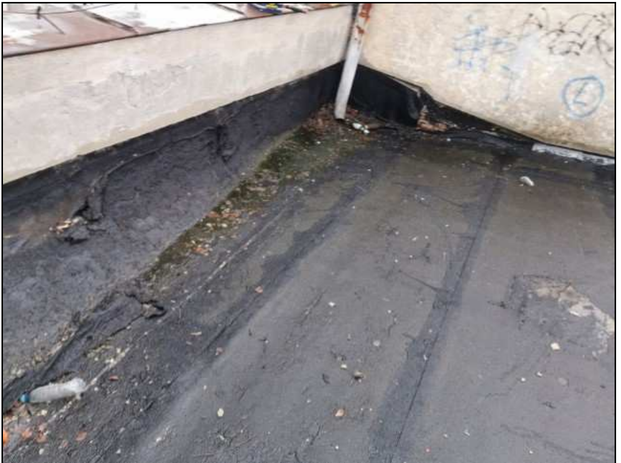
Fot.4 Połączenie wschodnia dachu, z nieodróżnioną instalacją odprowadzającą wody deszczowe
