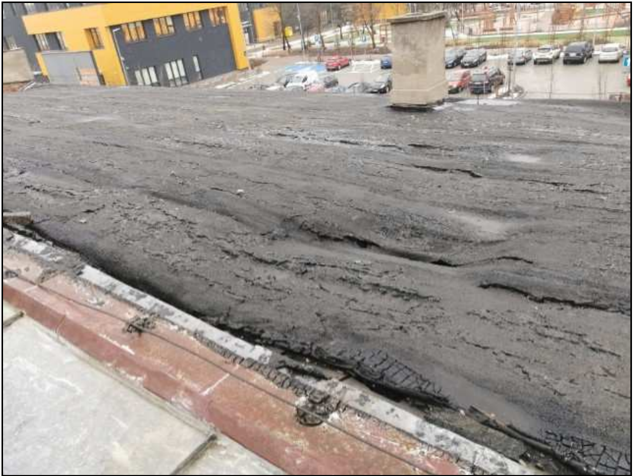
Fot.2 Połączenie zachodnia dachu, awaryjny stan pokrycia wraz z zapadniętym deskowaniem.
