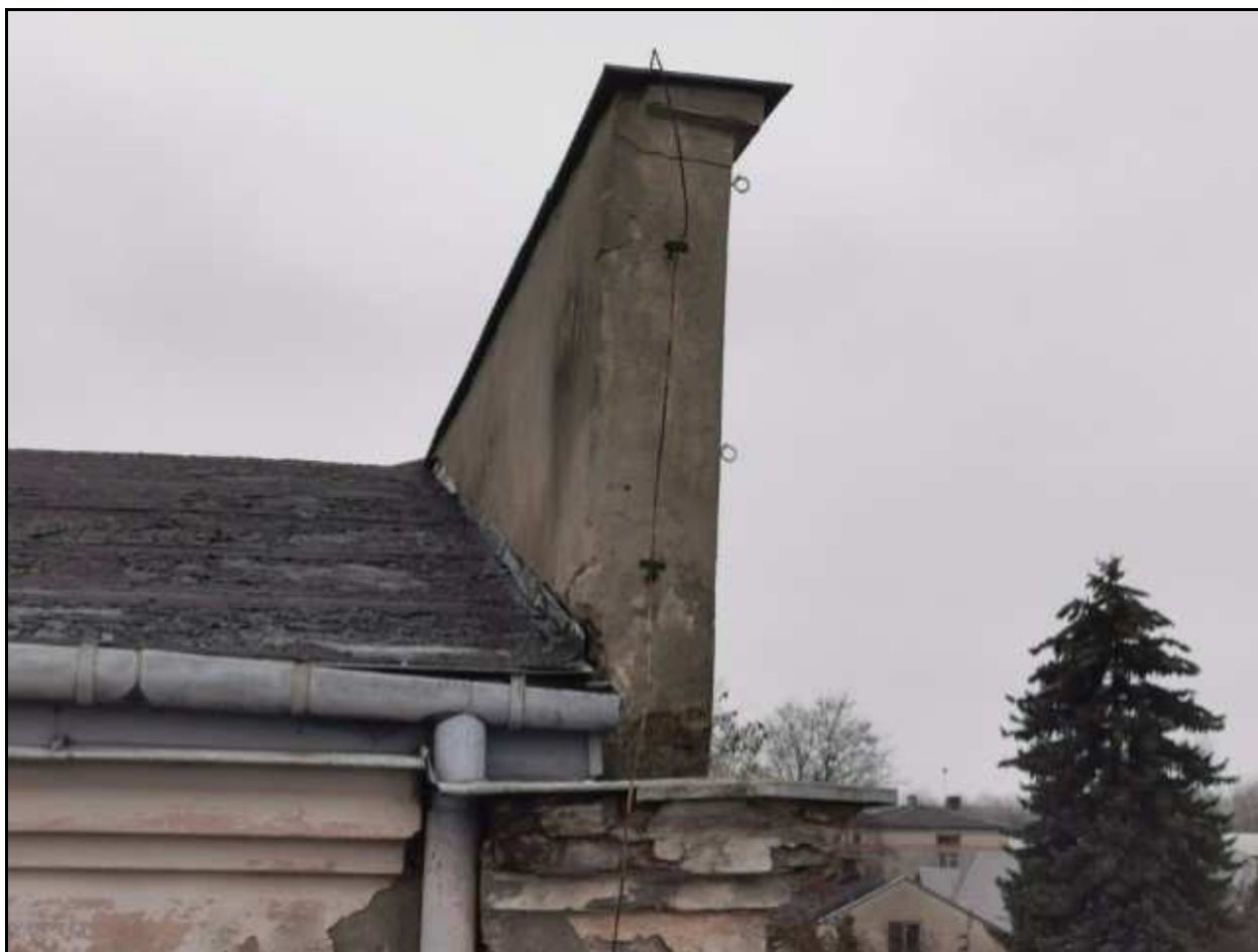
Fot.6 Ściana północna, wolnostojąca odchylona od pionu attyka
