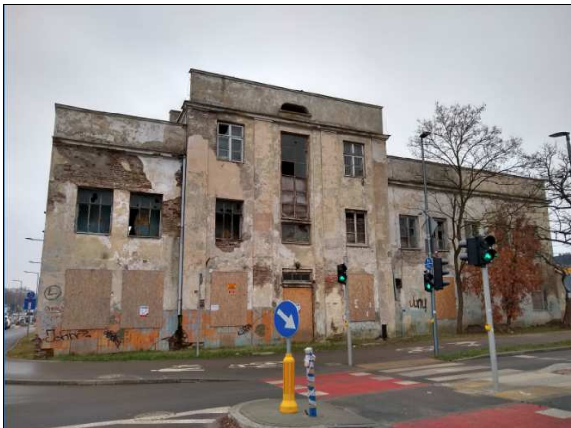
Fot.1 Elewacja Północna z attyką grożącą zawaleniem
