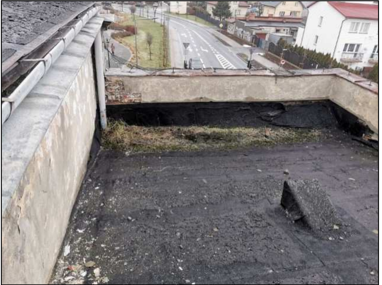
Fot.5 Połączenie północno-wschodnie dachu, z nieodróżnioną instalacją odprowadzającą wodę deszczową
