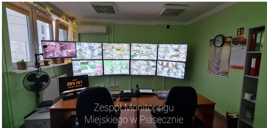
Sala operatorów monitoringu miejskiego na ul. Czajewicza 1 a w Piasecznie.
