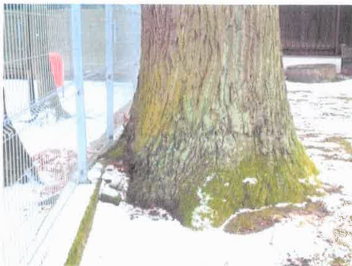
Nabiegi niszczące podmurówkę ogrodzenia
