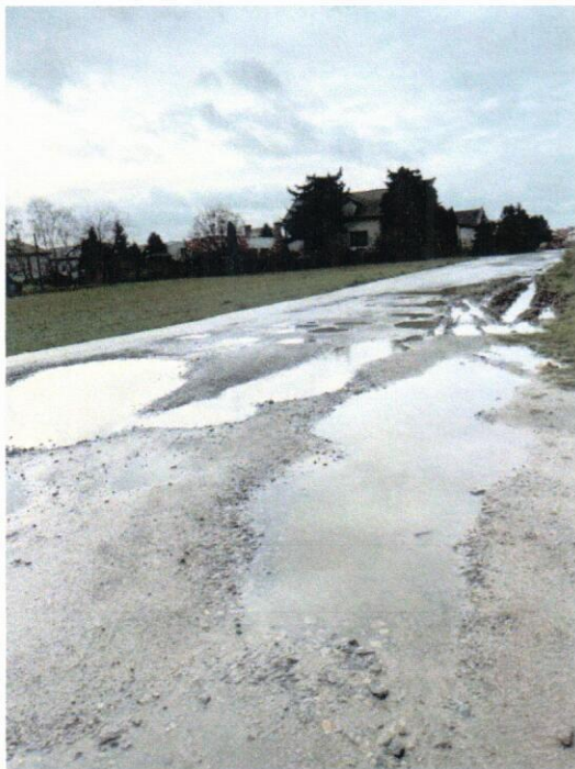
Zdjęcie nr 10 – Stan drogi z dnia 14 listopada 2023 roku
