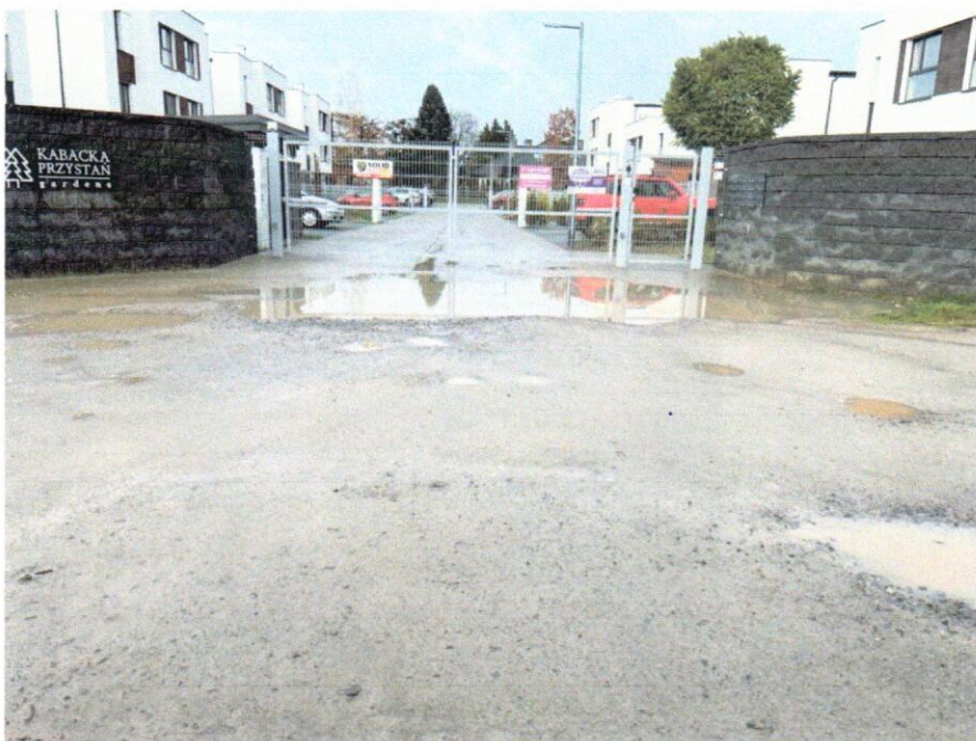
Zdjęcie nr 7 – Stan drogi z dnia 14 listopada 2023 roku
