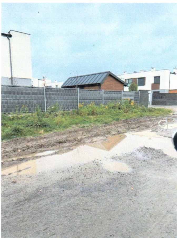
Zdjęcie nr 8 – Stan drogi z dnia 14 listopada 2023 roku
