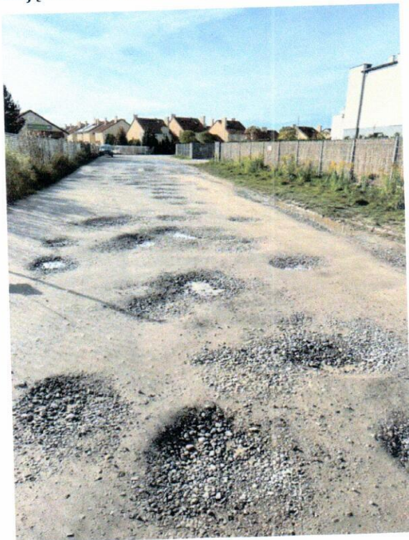
Zdjęcie nr 4 – Stan drogi z dnia 10 listopada 2023 roku
