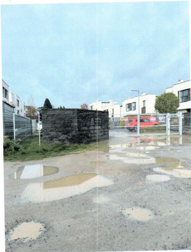
Zdjęcie nr 6 – Stan drogi z dnia 14 listopada 2023 roku
