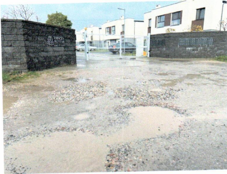
Zdjęcie nr 5 – Stan drogi z dnia 14 listopada 2023 roku
