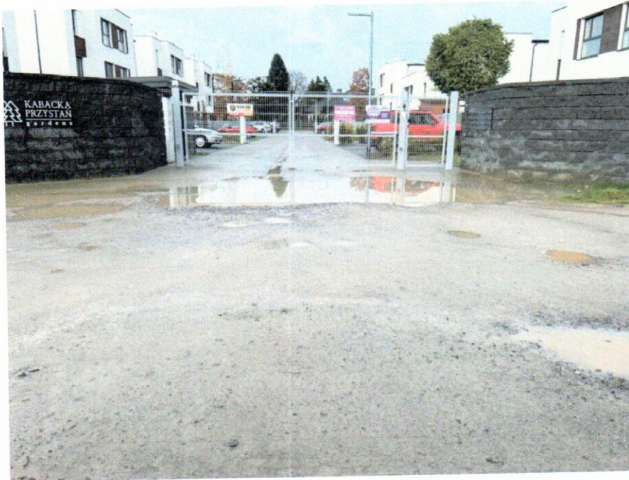
Zdjęcie nr 7 – Stan drogi z dnia 14 listopada 2023 roku
