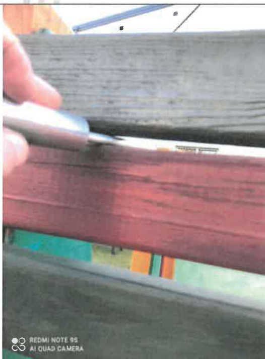
Zakleszczenie palca w szczelinie balustrady. Należy podjąć działania naprawcze
