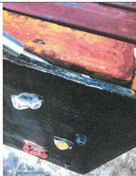
Zakleszczenie palca w szczelinach pomiędzy ścianką wspinaczkową i podestem. Należy podjąć działania naprawcze i monitorowanie materiału ścianki.
