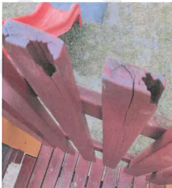
Spróchniałe i wyszczerbione elementy balustrady. Należy podjąć działania naprawcze
