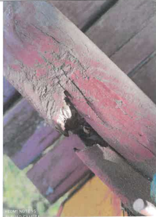
Uszkodzenia belki podestu. Należy podjąć działania naprawcze
