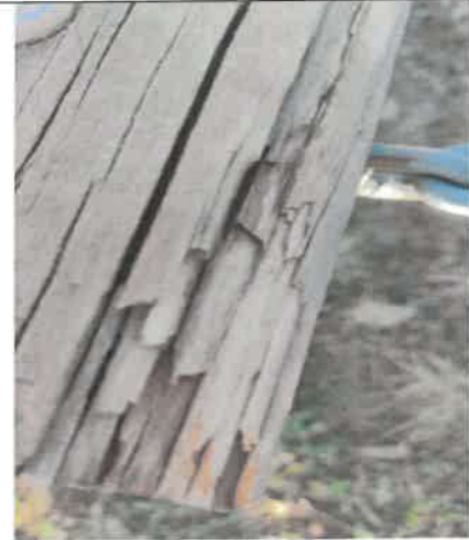
Ubytki w belkach pomostu. Należy podjąć działania naprawcze
